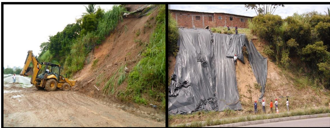
Figura 35 – Limpeza da via e ação paliativa adotada pela Defesa Civil-JP (Jun, 2014)
