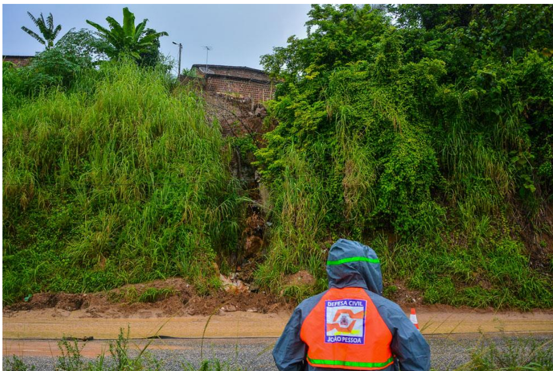
Figura 36 – Agente da Defesa Civil-JP observa voçoroca provocada por enxurradas no prolongamento do talude (Mai, 2016)
