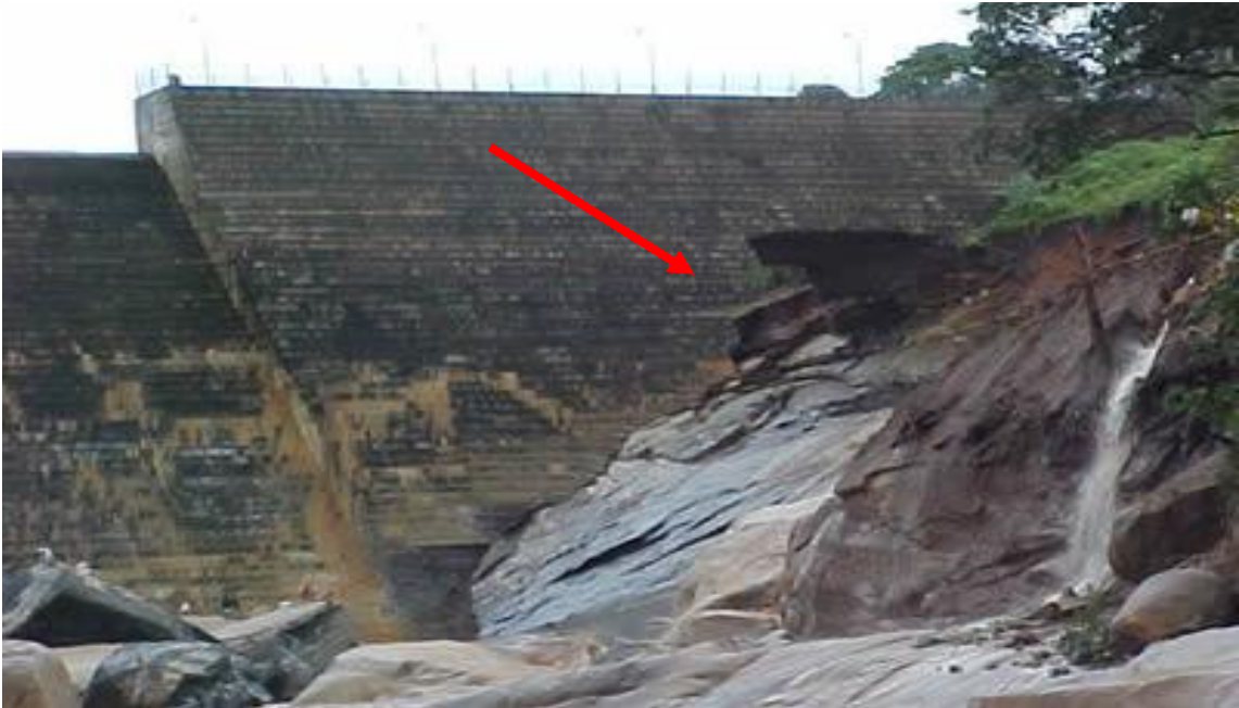
Imagem 1: Local de rompimento da Barragem Camará, Alagoa Nova – PB.
