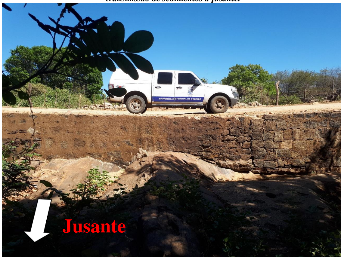
Figura 2. Passagem molhada sem canalizações, corroborando para o impedimento da transmissão de sedimentos à jusante.
