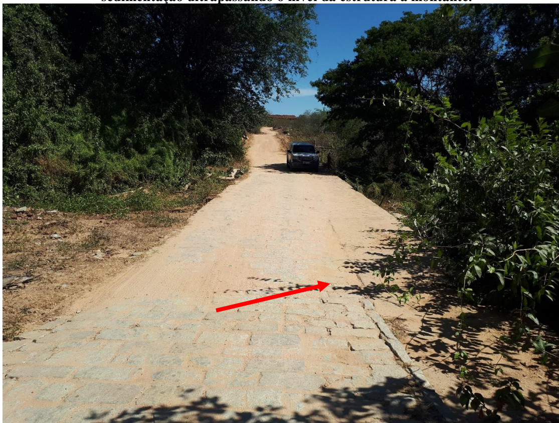
Figura 21. Passagem molhada sem canalizações, composta de blocos e cimento, com sedimentação ultrapassando o nível da estrutura a montante.
