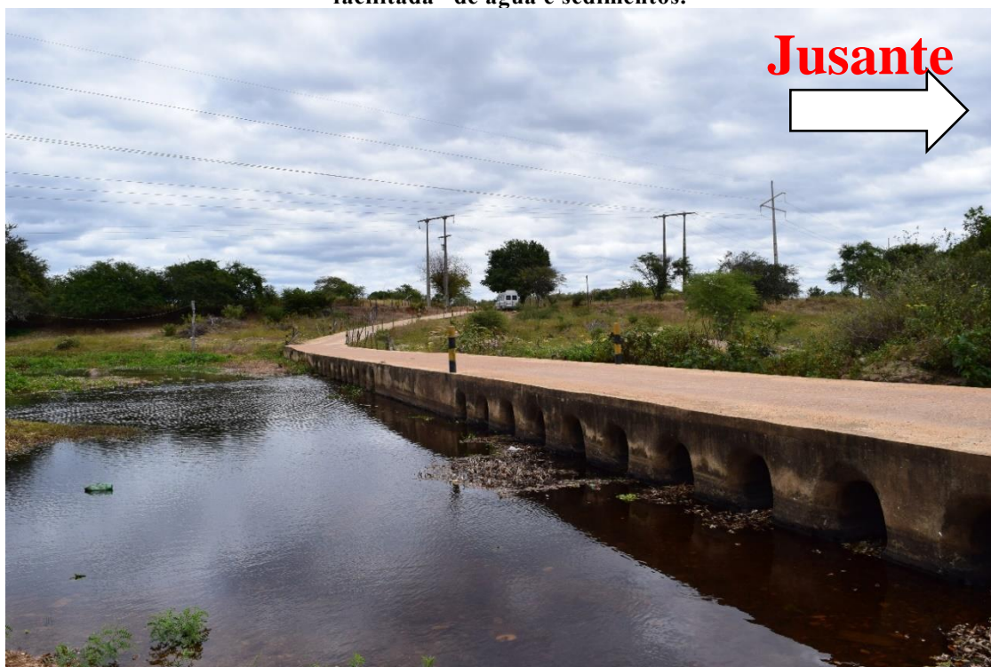
Figura 1. Passagem molhada com canalizações no meio da estrutura, permitindo a passagem “facilitada” de água e sedimentos.
