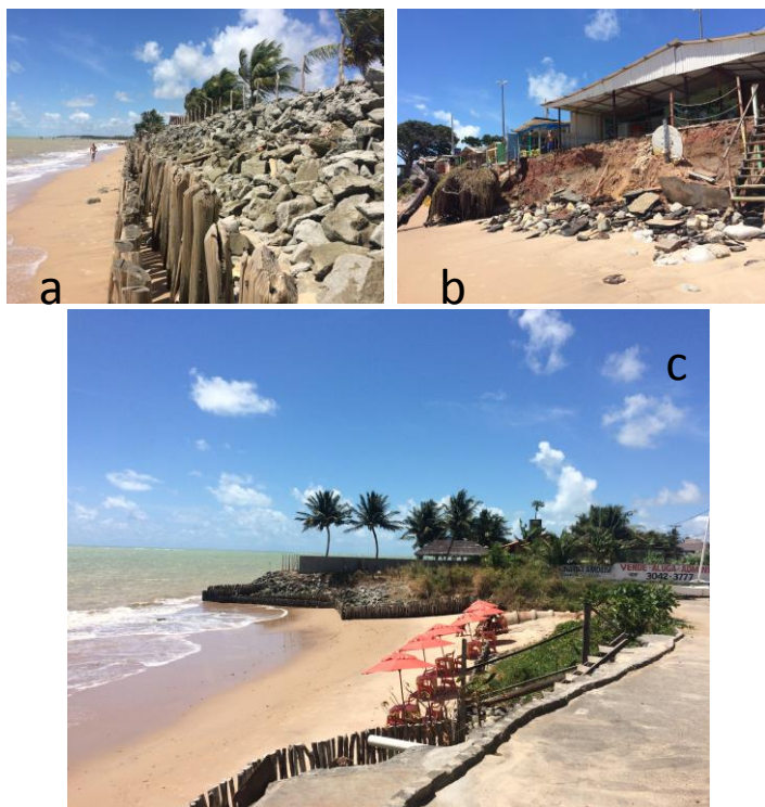
Figura 8: Geoindicador XI de erosão costeira. Destruição de estruturas artificiais para proteção costeira, praia do Seixas, 09 de outubro de 2017. (Fotos da autora).
