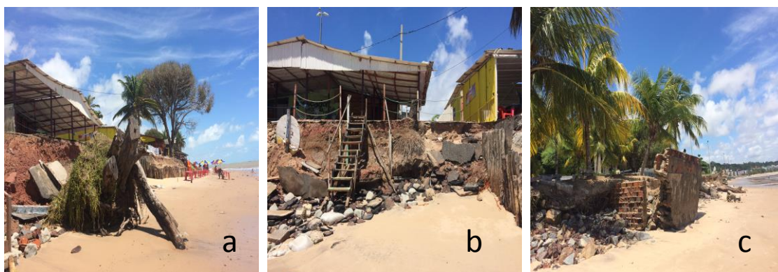
Figura 7: Geoindicador X de erosão costeira. Infraestrutura da orla danificada pela energia das ondas, (a, b) Ponta do Seixas, (c) Pç. de Iemanjá, praia do Cabo Branco, 09 de outubro de 2017. (Fotos da autora).
