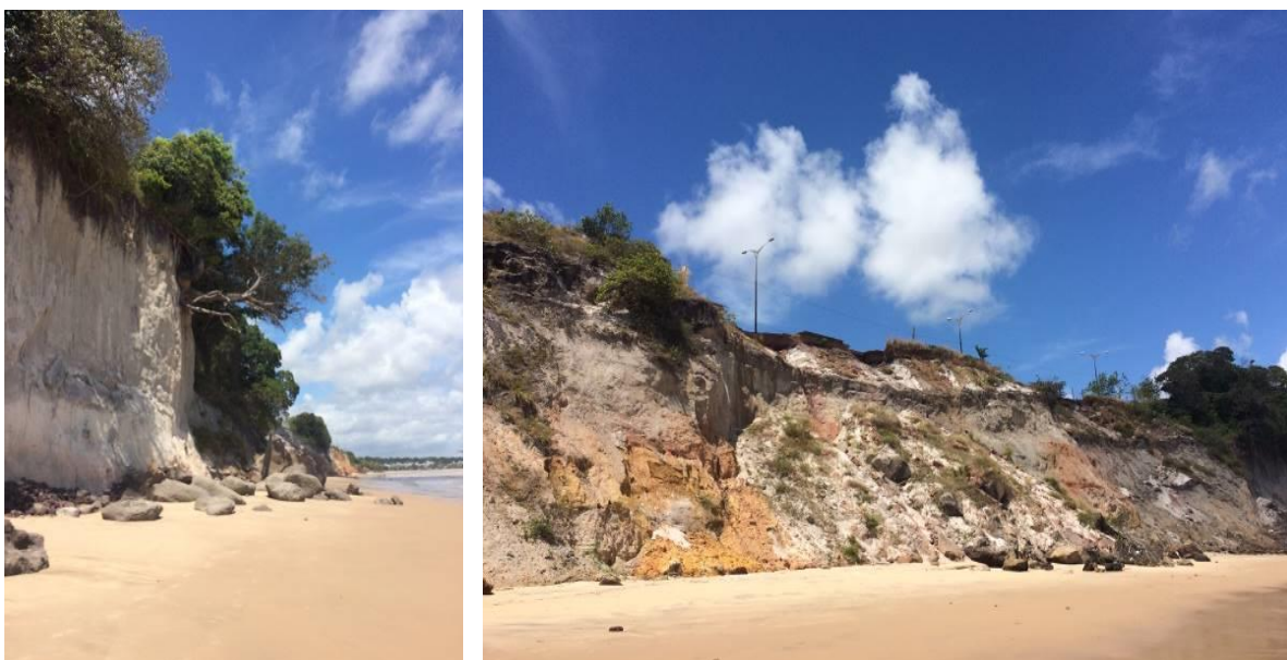
Figura 5: Geoindicador IX de erosão costeira. Presença de falésias vivas com alturas de até dezenas de metros em rochas sedimentares (Formação Barreiras) que bordeja a Ponta do Cabo Branco (acima), em 09 de outubro de 2017. (fotos da autora).
