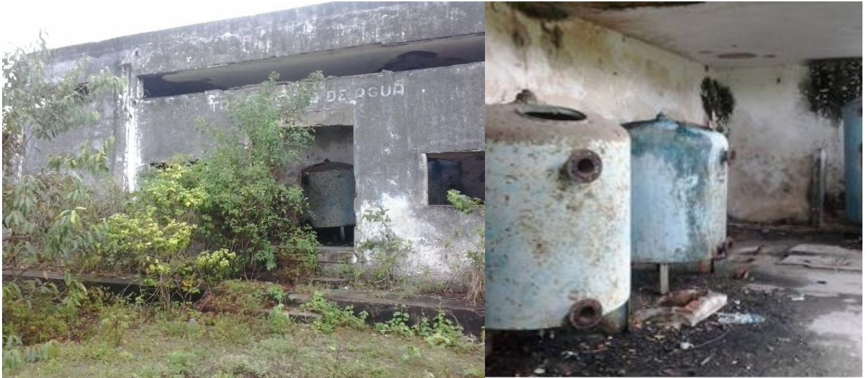
Figuras 14 e 15: Ruínas da estação de tratamento de água. Fonte: Arquivo do autor da pesquisa, em março de 2015.
