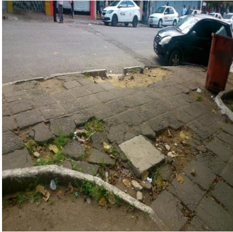
Figura 10: Calçadas do Parque Sólon de Lucena quebradas em varias partes. Fonte: Daniel Gomes. 06/04/2015.
