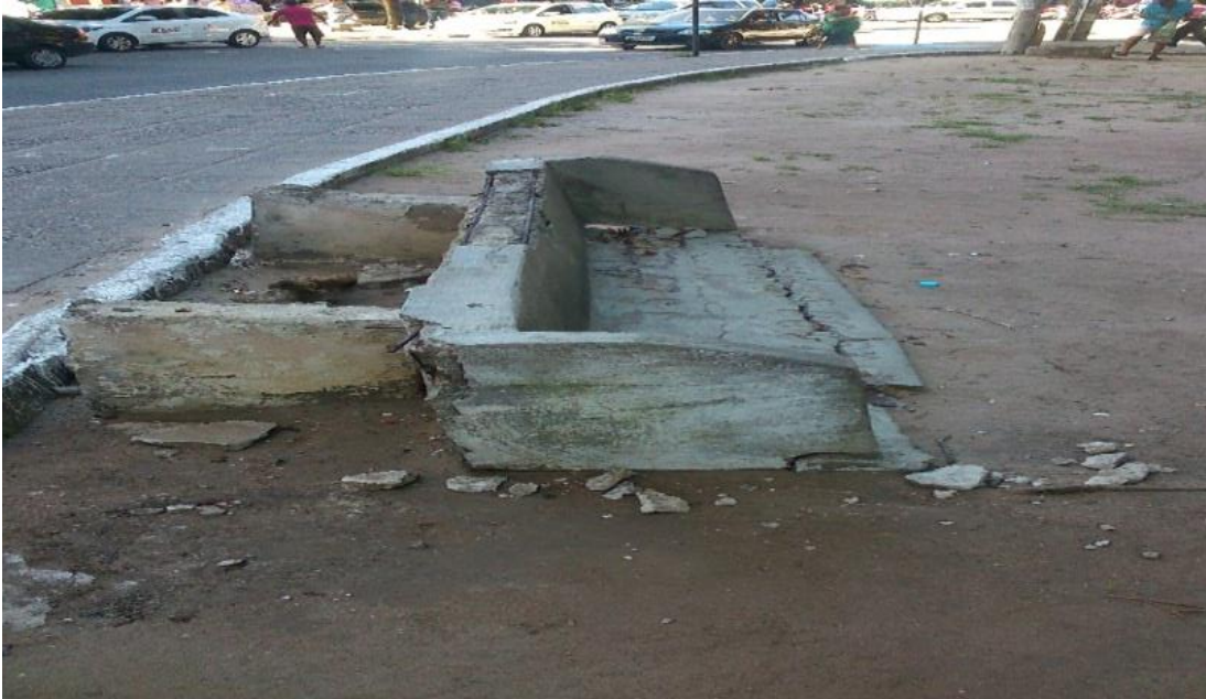
Figura 9: Banco do parque totalmente destruído. Foto do autor em 19/06/2015.
