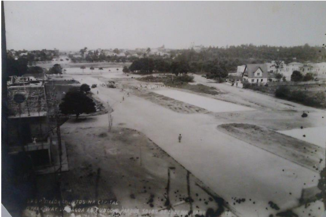
Figura 3: Início das obras da Parkway. 1938. Avenida Getúlio Vargas e Lagoa, ao fundo. Acervo Gilberto Stuckert.
