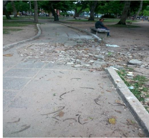
Figura 11: Outro trecho da calçada do Parque totalmente destruído. Fonte: Daniel Gomes. 06/04/2015.
