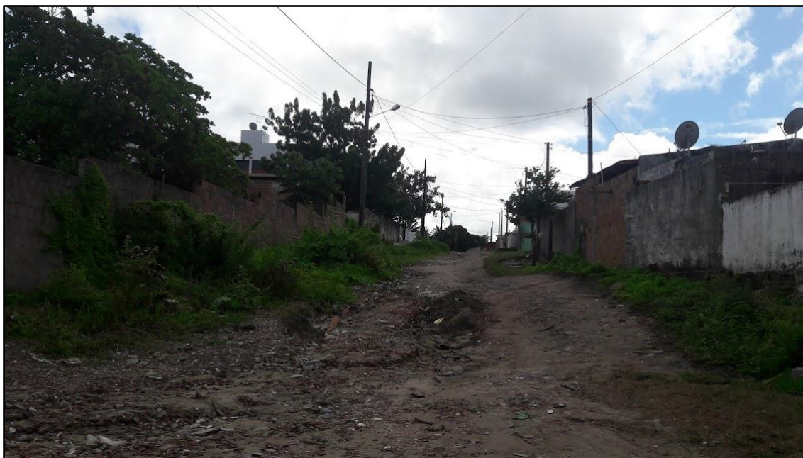
Figura 1 – Fotografia da Rua Josefa Pontes Cesar, com destaque para os buracos.
