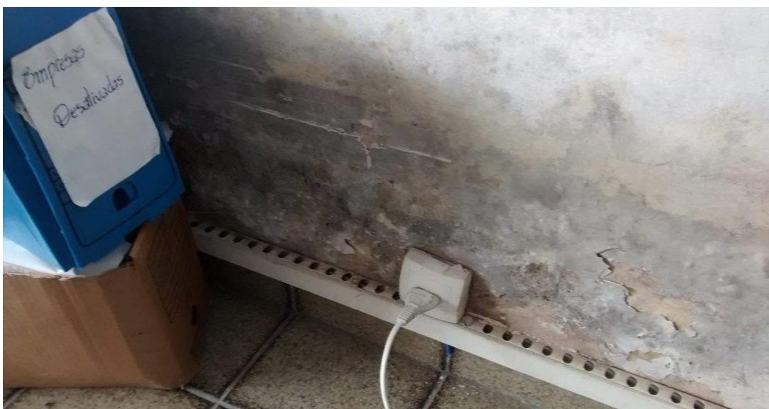
Fotografia 10: Documentos próximos a fiação elétrica e infiltração
