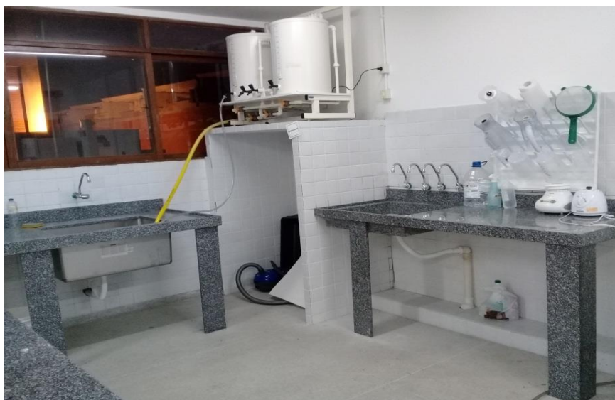
Figura 5 - Sala de Tratamento Aquoso
